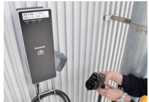
電気トラック用の充電用コンセント
