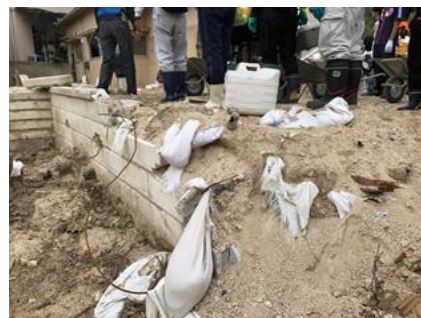
塀の高さまで堆積した土砂
