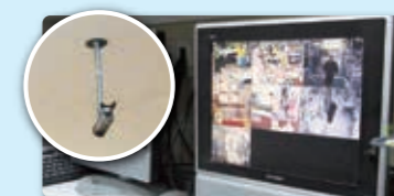
▲店舗に設置された監視カメラとモニター
