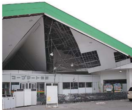
軒下の天井が落下したコープmart保原。コープふくしまで大きな被害を受けた店舗のひとつ。
