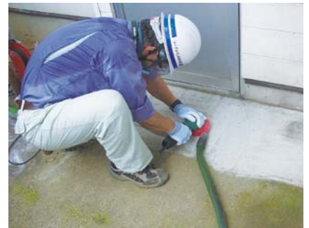
研磨機が使えない狭い場所は、手作業でコンクリートの表面を削る。
