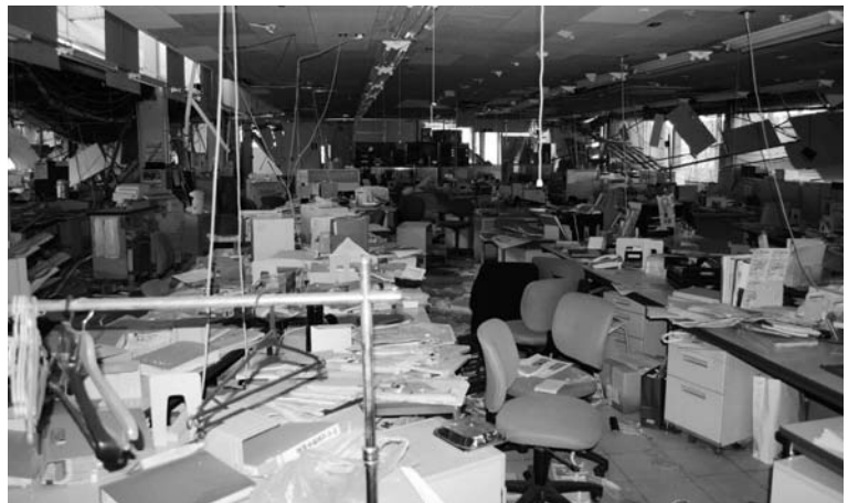
天井が落ちたみやぎ生協本部A棟。▶
